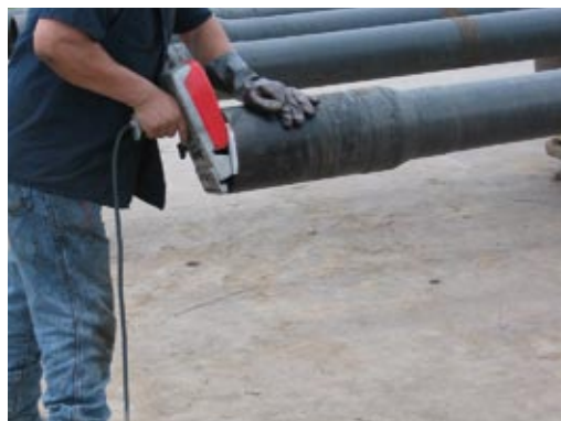
Marcaje de tubos
